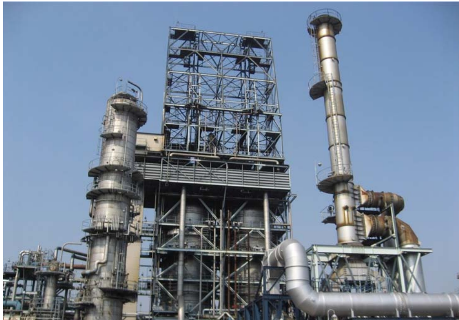
「重質油熱分解装置」の全体写真
