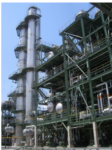
再稼働するMX生産装置
