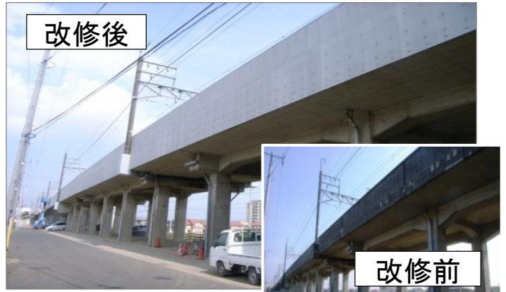
&lt;パワロン&gt;ボードを使用した鉄道高欄改修の施工例
