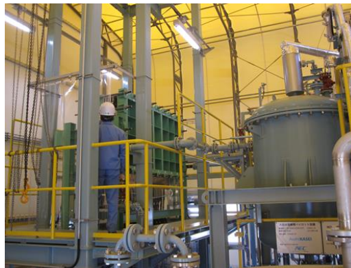
大型アルカリ水電解設備
