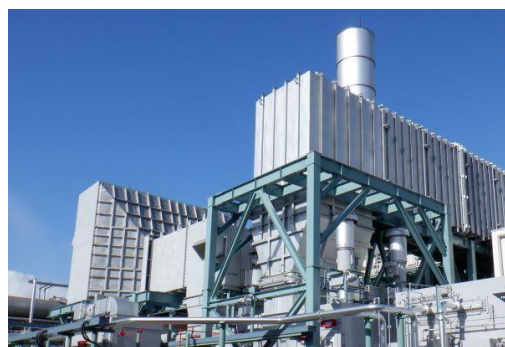
ガスタービン発電設備
