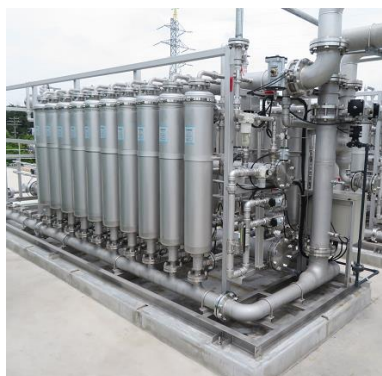
クラレ倉敷事業所内に設置した〈ピューリア〉GL
