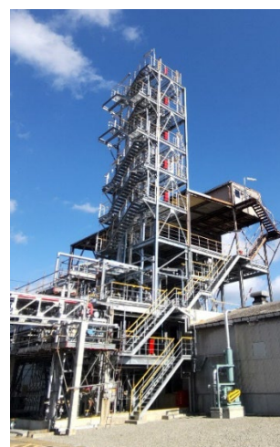
ケミカルリサイクル実証設備
