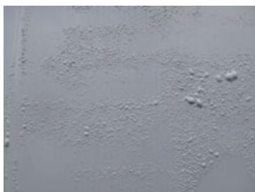
泡による塗膜欠陥
