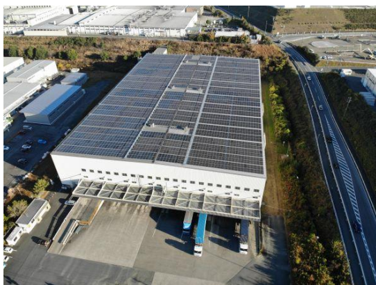
新城南工場内の屋根に設置した太陽光発電システム
