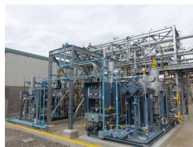
パイロット設備の外観
