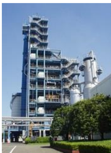
川崎プラスチックリサイクル（KPR）プラント
