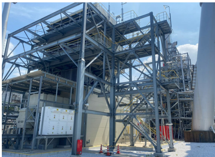
高効率ガスタービンコージェネレーション 外観
