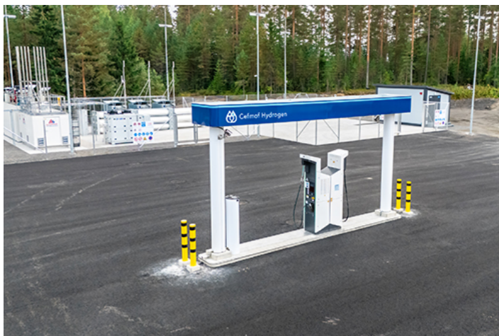
商用水素ステーション(Cefmof Hydrogen提供)
