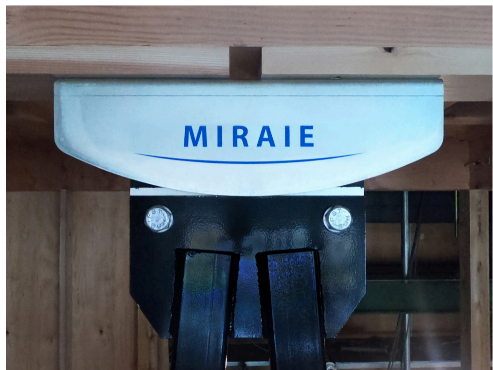
高減衰ゴムが設置されたダンパー部分 ※4
