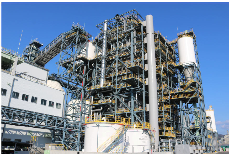
バイオマス発電所
