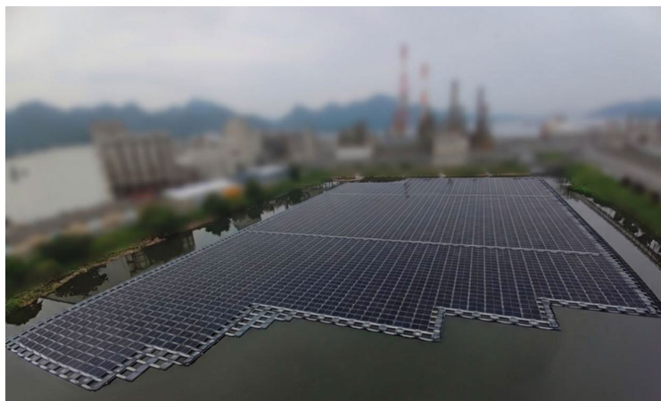
水上設置型太陽光発電設備
